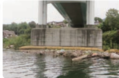
日連大橋の橋脚に集まったゴミ
