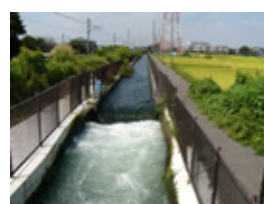
相模川左岸幹線用水路
